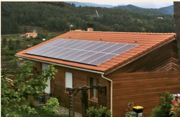
Installation sur maison individuelle
