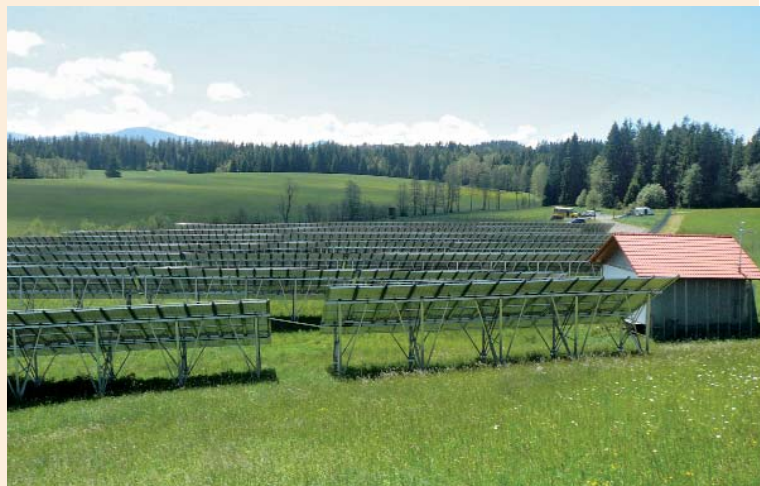
Centrale photovoltaïque au sol en zone agricole
